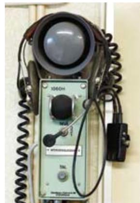
Intercom till reservkraftsrum.
