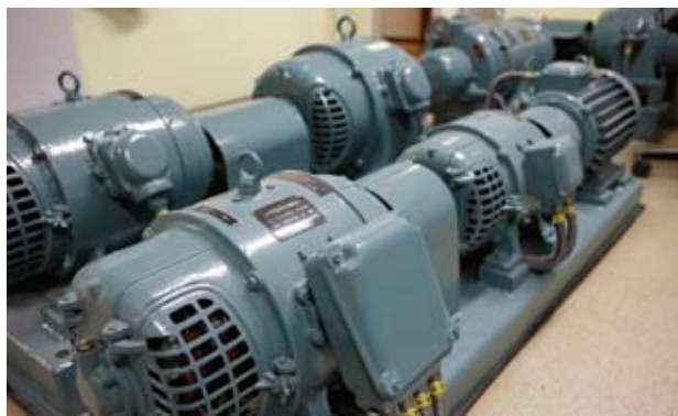
Magnetiseringsomformare som styr de stora omformarna.
