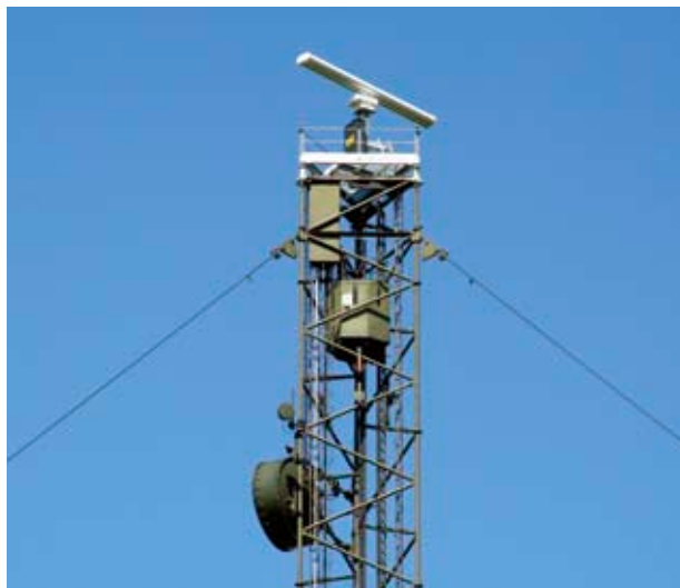
PS 640 efter montering av antenn.
